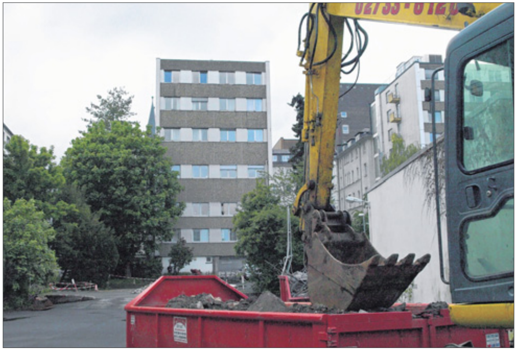
Vor dem D-Flügel des St. Marien-Krankenhauses stehen bereits die Bagger bereit: Für rund 6,5 Mio. Euro aus Eigenmitteln soll er bis 2012 modernisiert werden.
