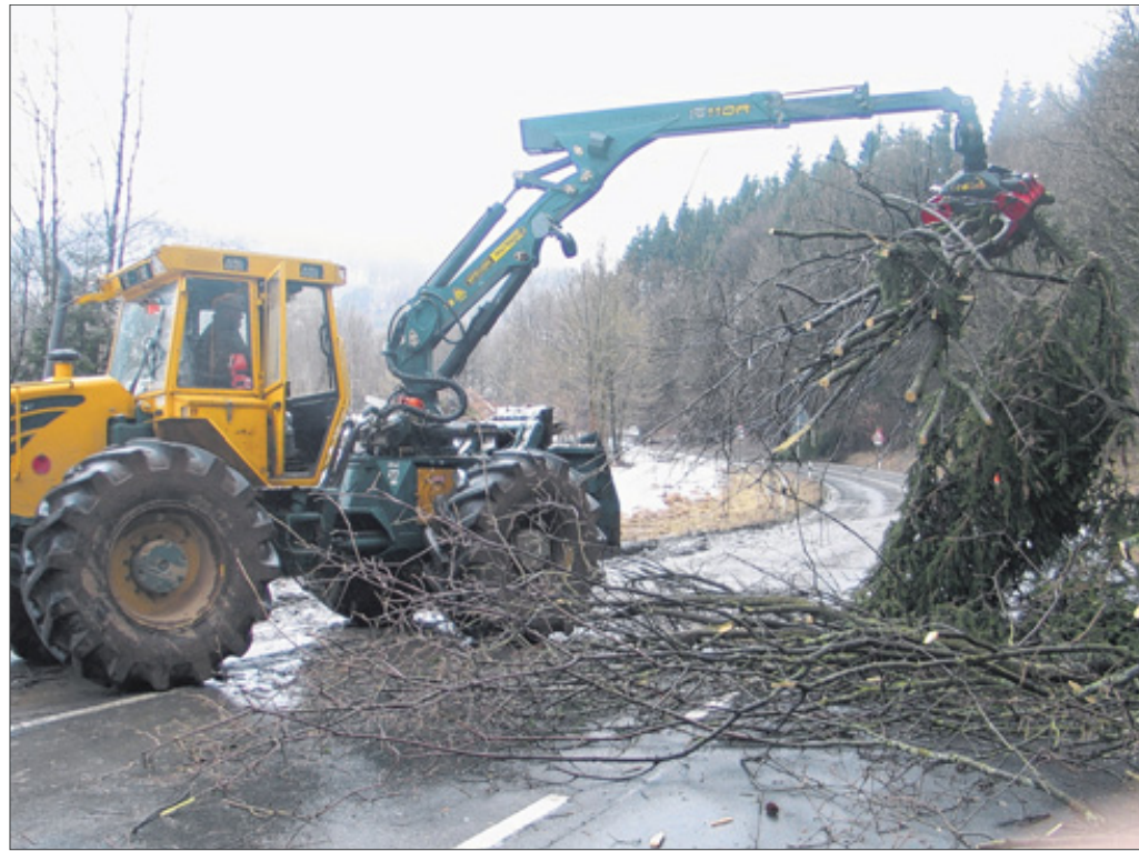
Aufräumen nach Sturm „Xynthia“ auf der B 480 zwischen Bad Berleburg und Raumland: Mit schwerem Gerät wurden die Bäume und Äste am Montag von der Fahrbahn beseitigt. Foto: vö
