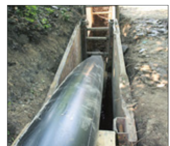
Keine lange Gräben sind nötig, um im sogenannten Relining-Verfahren meterlange Kunststoffrohre zu verlegen.
